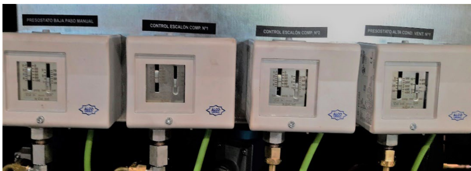
Figura 12: Presostatos funcionamiento manual
