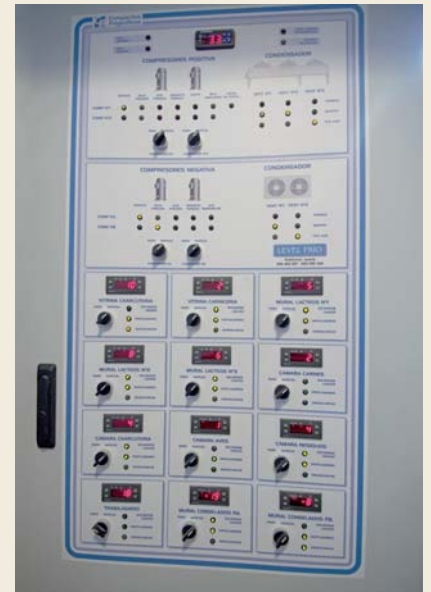
Panel de control de la instalación de frío.
