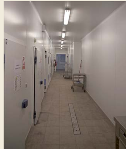
Zona de cámaras de producto refrigerado y congelado.
