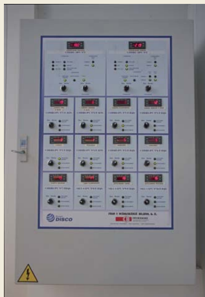
Cuadro de control de temperaturas de las distintas cámaras de refrigeración, congelación y obradores.
