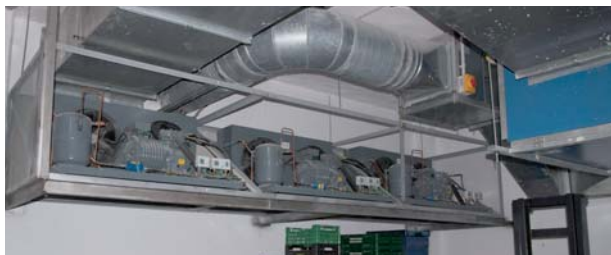
En la foto, las tres unidades condensadoras semiherméticas ubicadas en el sótano de la residencia.
