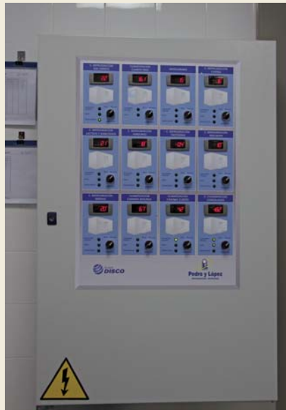
Detalle del panel de control de temperaturas de todas las cámaras.
