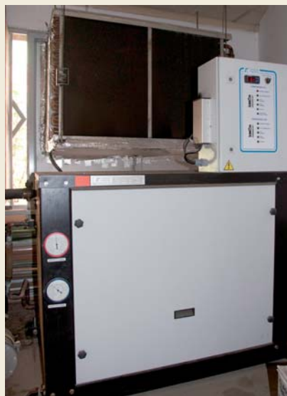
Instalación de la central CFA en un rincón de la sala de máquinas.
