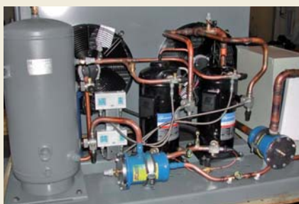
La mini-central axial Digital Scroll instalada, cubrió sobradamente los requerimientos de reducción de espacio y ahorro energético establecidos por la propiedad.
