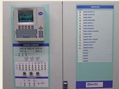
Vista del cuadro eléctrico con el controlador E2.
