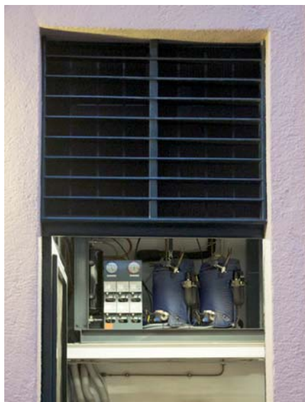
En la foto, instalación de la central a medida, aprovechando el hueco de las escaleras de la parte trasera del restaurante.
