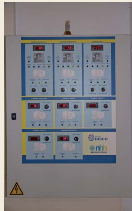
Panel de control de temperaturas de las cámaras de conservación, verduras, carnes y pescados y cuartos fríos.
