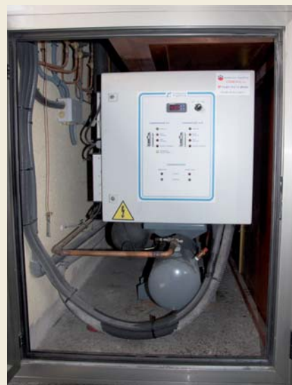
Vista lateral de la central de dos compresores Digital Scroll.
