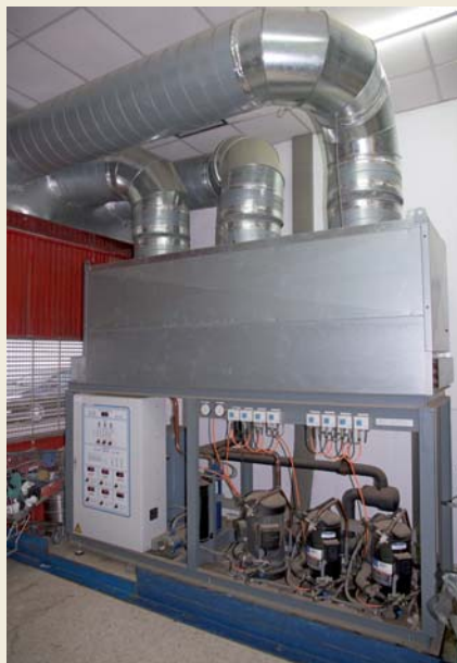
Central Digital Scroll de tres compresores, situada en el almacén del local.
