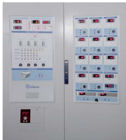
Sistema de telegestión XWEB de Dixell para el seguimiento y control de toda la instalación de frío en tiempo real.
