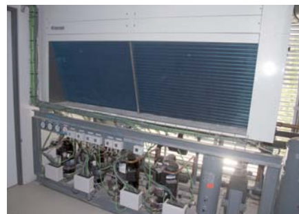
La central multiaspiración Scroll Digital en V, regula toda la demanda frigorífica del sistema desde la sala de máquinas.
