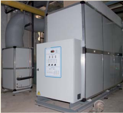
Central Digital Scroll CFA de tres módulos, ubicada en el sótano del hotel.
