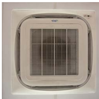
La instalación de refrigeración cubría también la climatización del local. En la foto, las máquinas Tango de aire acondicionado utilizadas para el clima.
