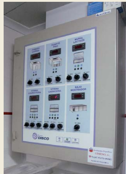
Panel de control de temperaturas del frío de la tienda.
