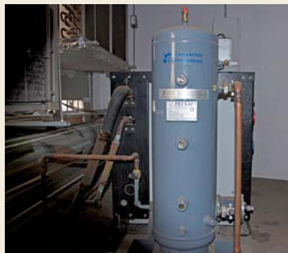
Detalle del recipiente de líquido de la central frigorífica.
