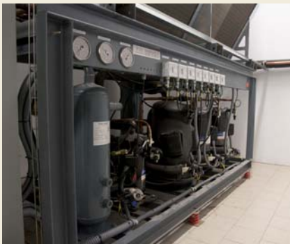
Detalle de los compresores Digital Scroll de Copeland incorporados en la central e insonorizados.
