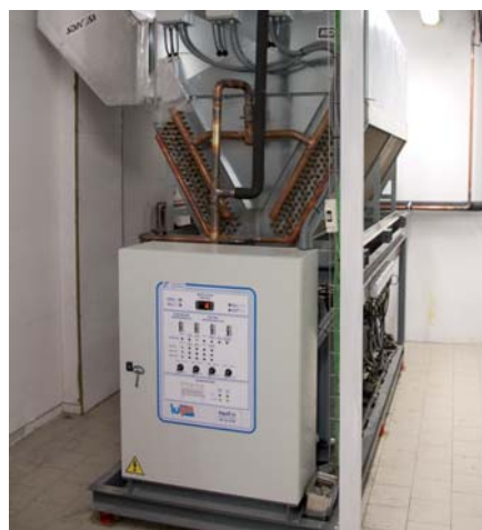
Central CFV instalada en la sala de máquinas del local.
